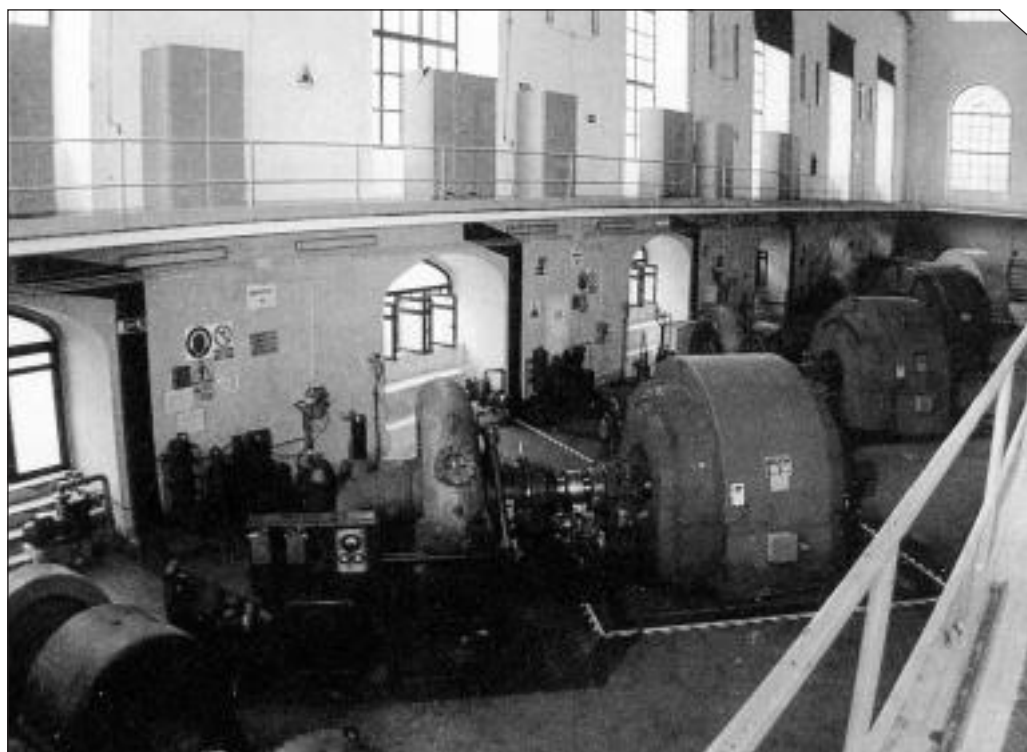
Colli al Volturno, centrale I salto, sala macchine.
