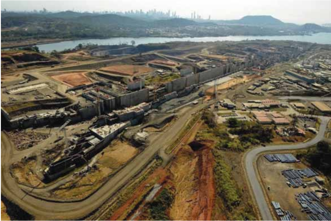
Fig. 2. Aree dei nuovi tronchi del canale sottoposte ad un profondo stravolgimento ambientale e territoriale per la profondità e vastità degli scavi, la rilocalizzazione dei materiali rimossi e la costruzione delle nuove chiuse.
